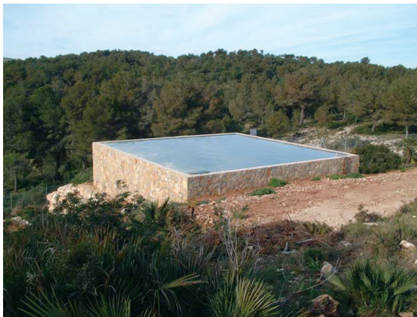
Figura 2 —Ejemplo de depósito de agua para su uso por los servicios de extinción.
